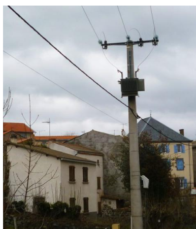
La Croze : l'arrivée de la haute tension, qui va être enfouie, et le transformateur
